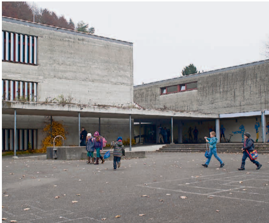
Schon bald soll die Fassade der Schulanlage Färberacker gereinigt und versiegelt werden.
